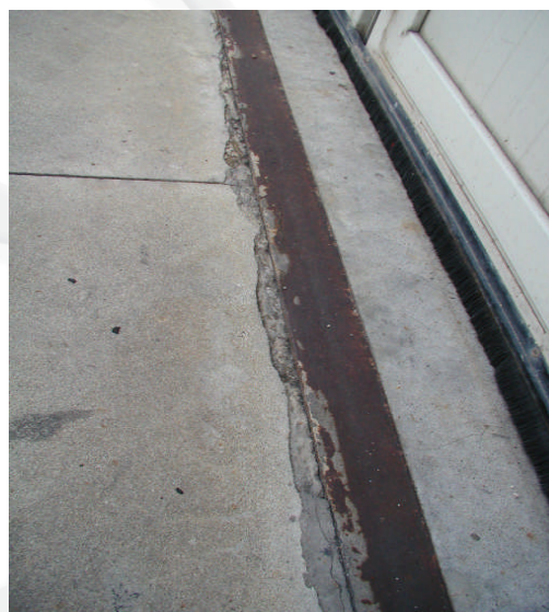
Esempio di pavimento industriale sbrecciato in prossimità della soglia
